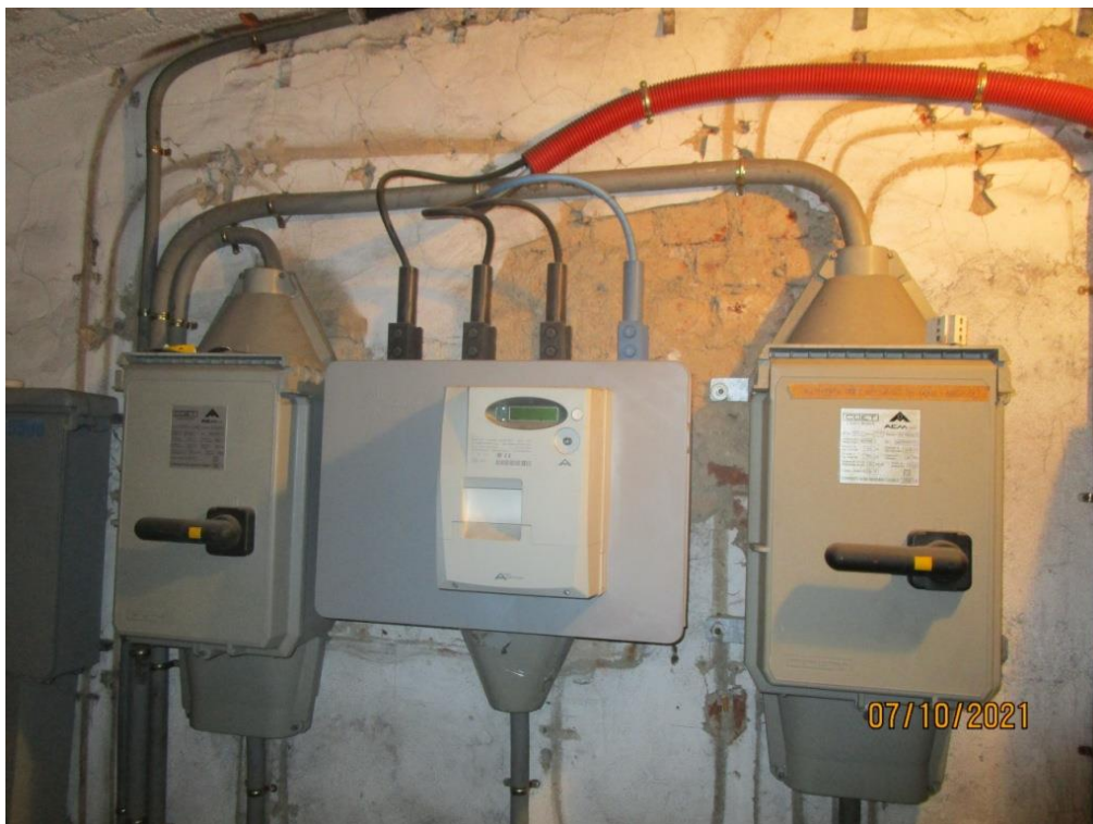
Foto 19 – Impianti presenti non di pertinenza dell'unità immobiliare: contatori Enel, quadri elettrici AEM (ora A2A), impianto idrico e fognario
